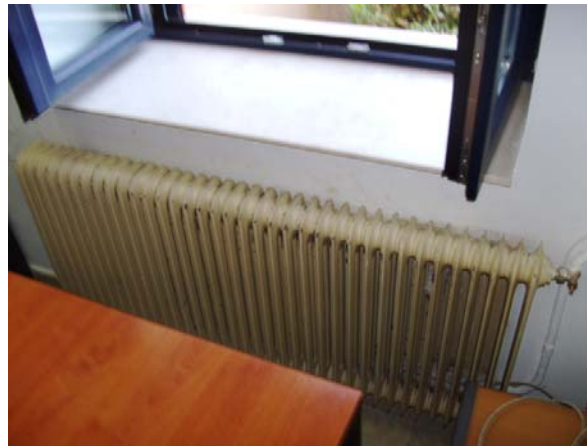
Εικόνα 5: Τερματικές Μονάδες Θέρμανσης Χώρων
