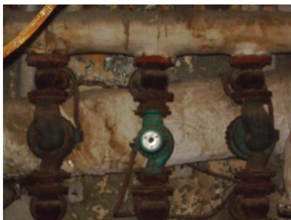
Σχήμα 6: Κυκλοφορητές Συστήματος Θέρμανσης Χώρων
