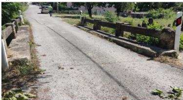
Φωτ. 1. Γέφυρα Αγ. Πάντες, Παλαιοχωρίου, διατομή <3.5μ
