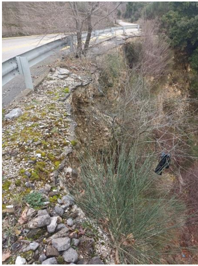
Κατολισθητικά φαινόμενα στην Επαρχιακή Οδό
