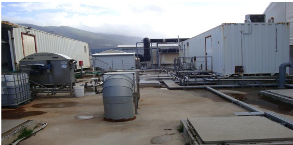
Εικόνα 13: Εγκαταστάσεις επεξεργασίας υγρών αποβλήτων
