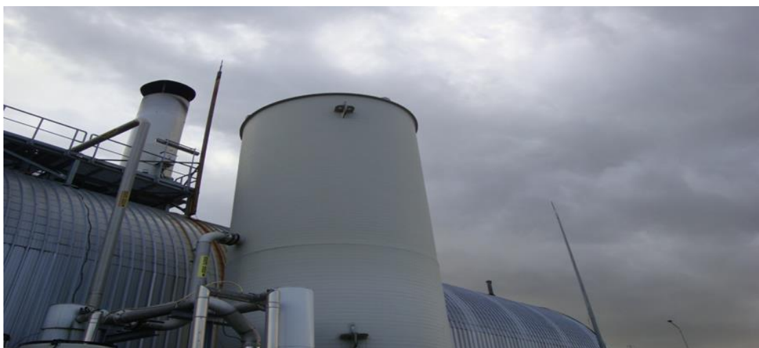
Εικόνα 8: Αποθείωση παραγόμενου βιοαερίου και πυρσός καύσης
