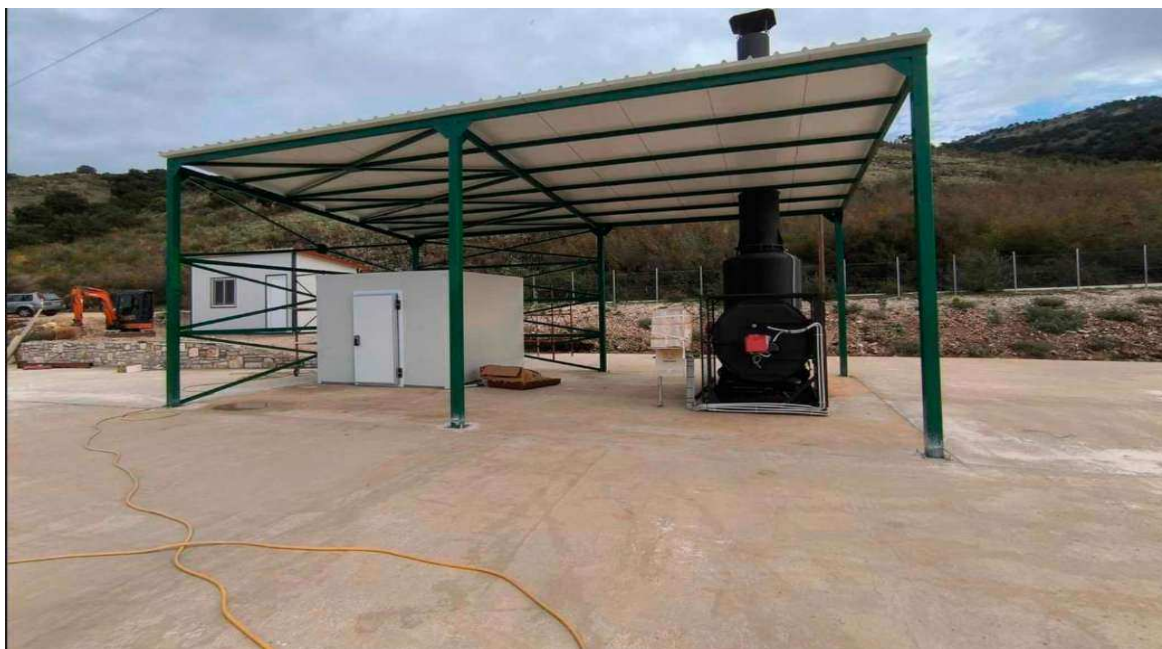
Εικόνα 2: Εγκατάσταση αποτεφρωτήρα - ψυκτικού θαλάμου στην υπό μελέτη μονάδα
